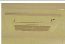
浴室暖房乾燥機
