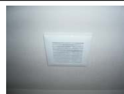
洗面室・トイレ換気扇
