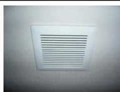
キッチン内吹出口
